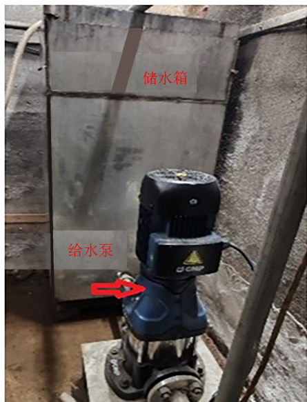
图2 储水箱和给水泵
